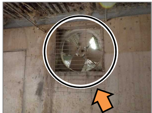
使用していない 換気扇が開口
