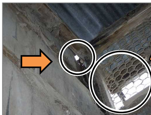
壁・屋根の隙間
